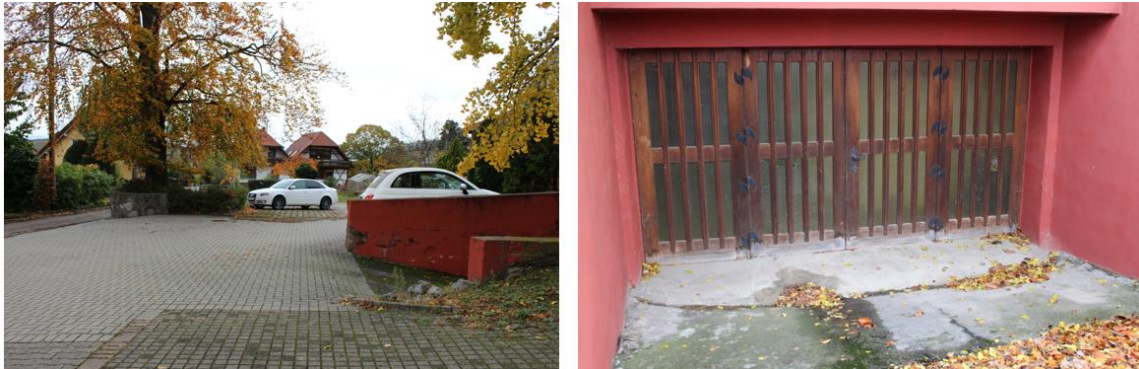
Abbildung 6: Gefahrenstelle Tiefgarageneinfahrt bei Starkregen: Einfahrt zur Tiefgarage in Hanglage, fehlende Abflussmöglichkeit bzw. Verstopfung durch Laub
